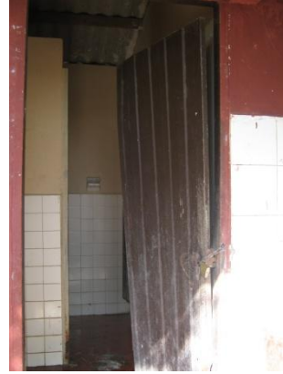
Estado de puerta
