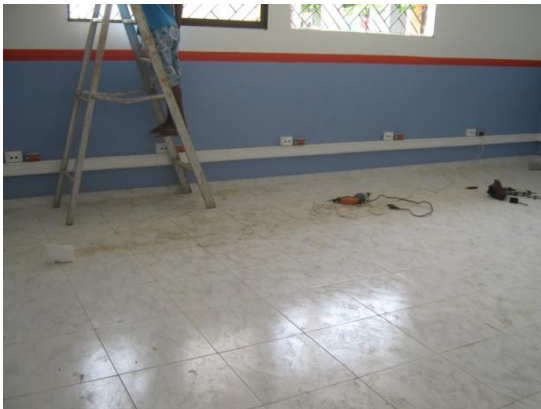
Toma corriente, cerámica piso
