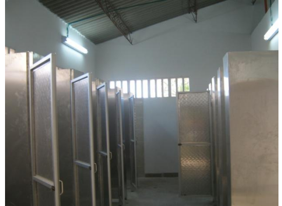
Puertas y divisiones metálicas
