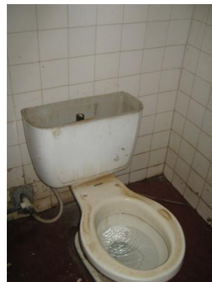
Estado de sanitario
