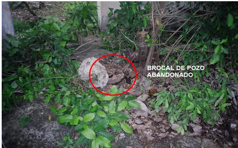
12.1 POZO ABANDONADO DEL SISTEMA DE ACUEDUCTO, LOCALIZADO EN LA FINCA PALO HUECO.
